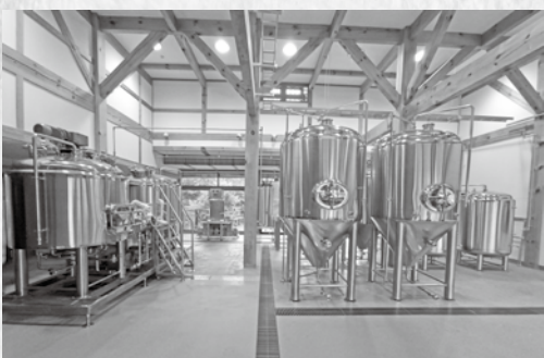
▲8月に導入された醸造設備
