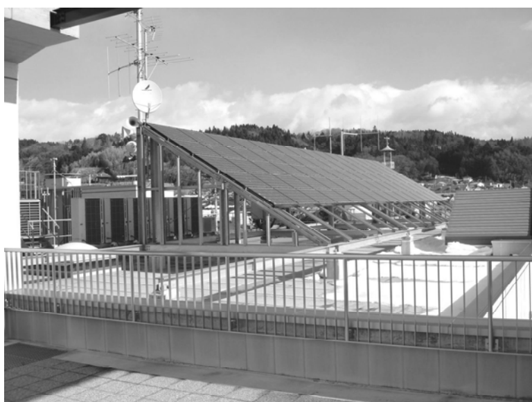
常葉行政局庁舎の太陽光発電パネル
