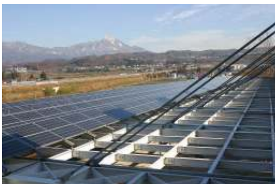
建物北側部分に設置された不透光型太陽光発電システム
