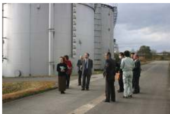
消化ガス発生工程の説明を受ける様子 (消化タンク及びガスタンク)
