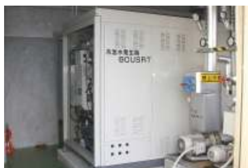
消化ガス利用冷暖房装置 （吸収式冷温水機）
