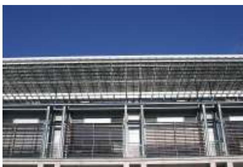
ハイテクプラザ会津若松技術支援センターの屋根部分に設置された太陽光発電モジュール
